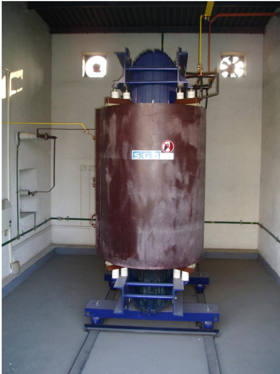
Obrázek 2-Příklad nevhodného chlazení
